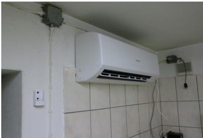
Heizgerät im Aufenthaltsraum
