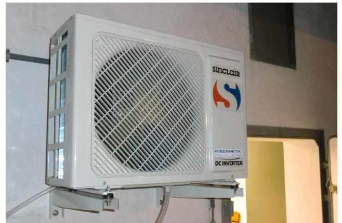
Wärmeentnahmeggerät im Gang
